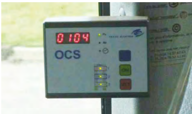
Boîtier d'affichage de la pression en cabine (Transelektro et BM Air)
